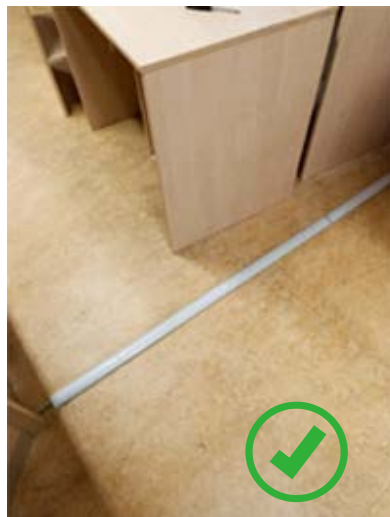
Obr. 6 Kabel překrytý přechodovým můstkem
